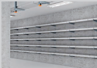
Kabeltunnel mit Bandagen in Kraftwerken.
