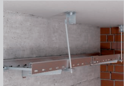
Deckenbefestigung der Gewindestangen mit Brandschutzbügel.
