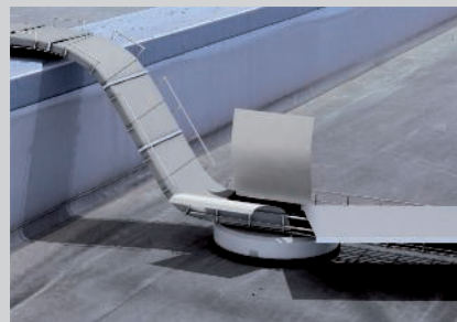
Einsatz bei über Brandwand geführten Photovoltaikleitungen.
