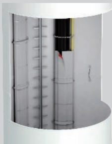
Bandagierte Steigetrasse im Turm einer Windkraftanlage.
