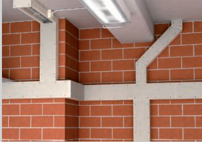
Montierter Brandschutzkanal an Wand und Decke als I- und E-Kanal.
