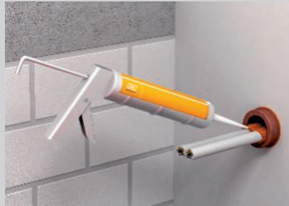
In leichten Trennwänden Einsatz der Minirohrschale FBA-DR.
